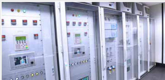
Armoires électriques / de commande
